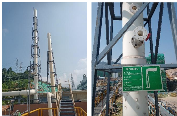
⑦化验室废气排放口 (DA007)
