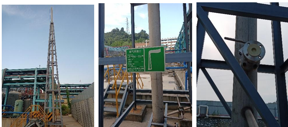
⑤酸碱罐区排放口 (DA005)
