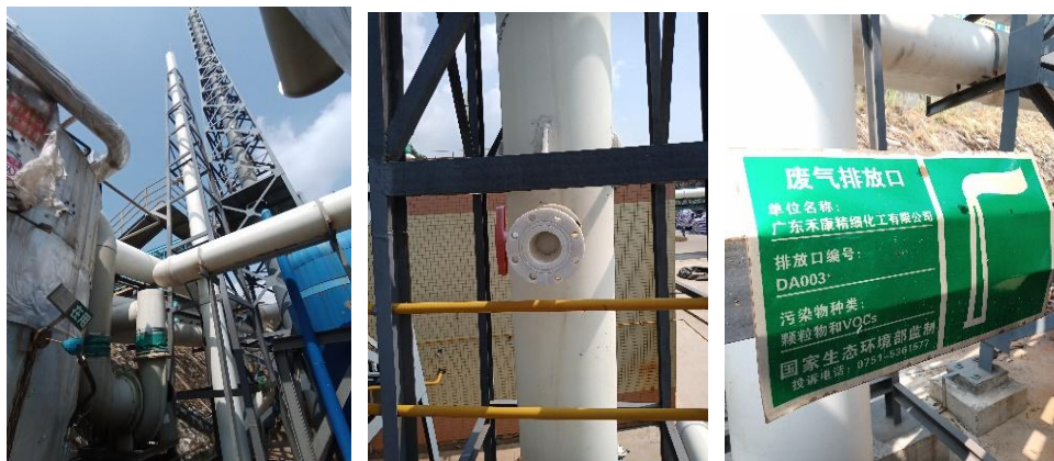
④甲类储罐区废气排放口 (DA004)
