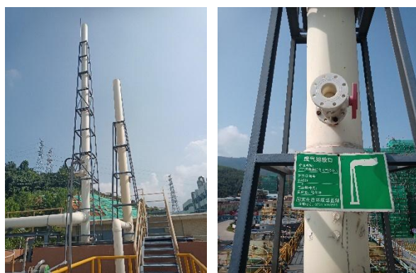
⑥液氯间气化废气排放口 (DA006)
