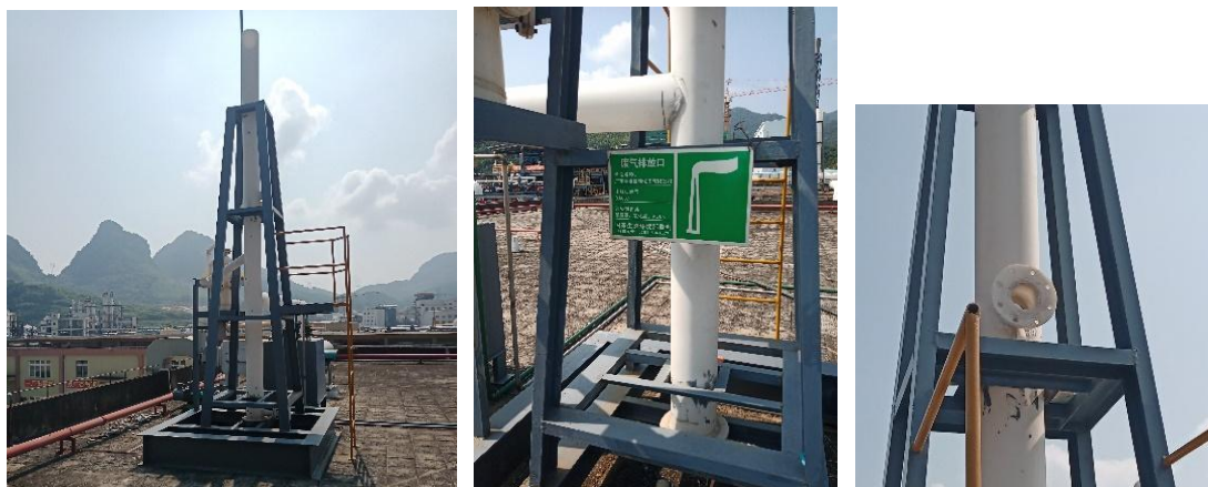
⑧备用发电机排放口 (DA008)
