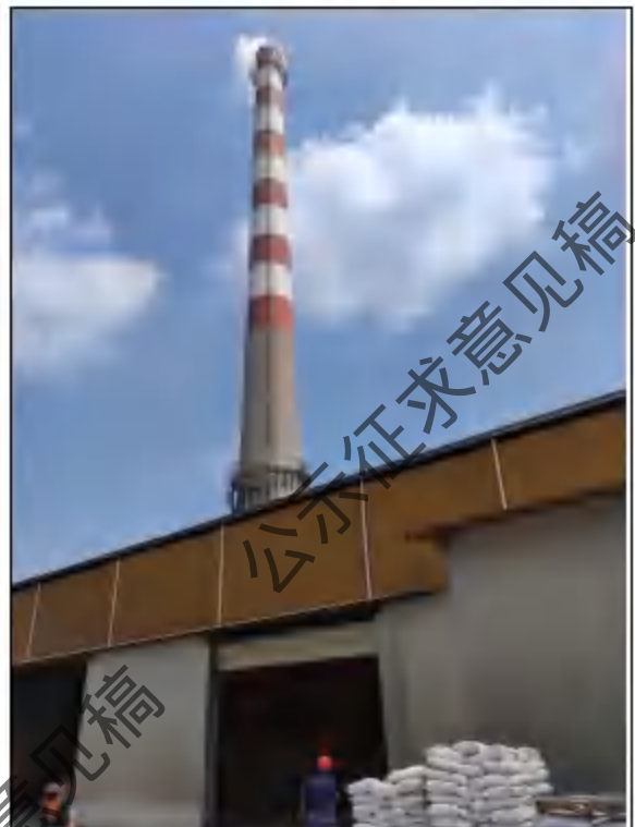
锅炉房废气排气筒
